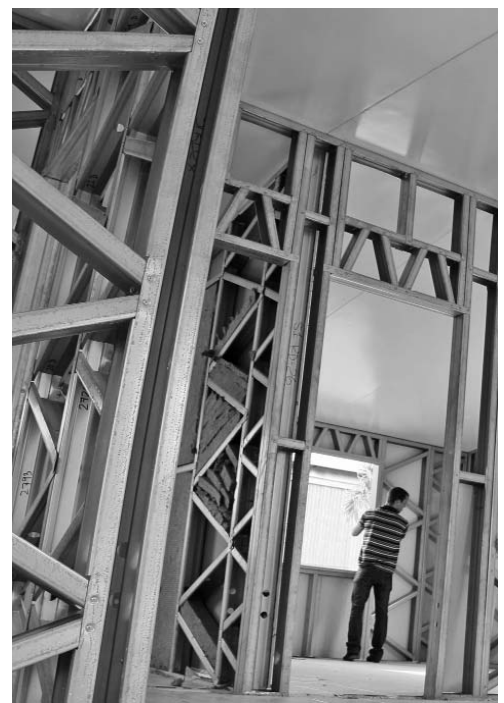
Este sistema posee una considerable flexibilidad de organización estructural y volumétrica según exigencias del diseño arquitectónico.
